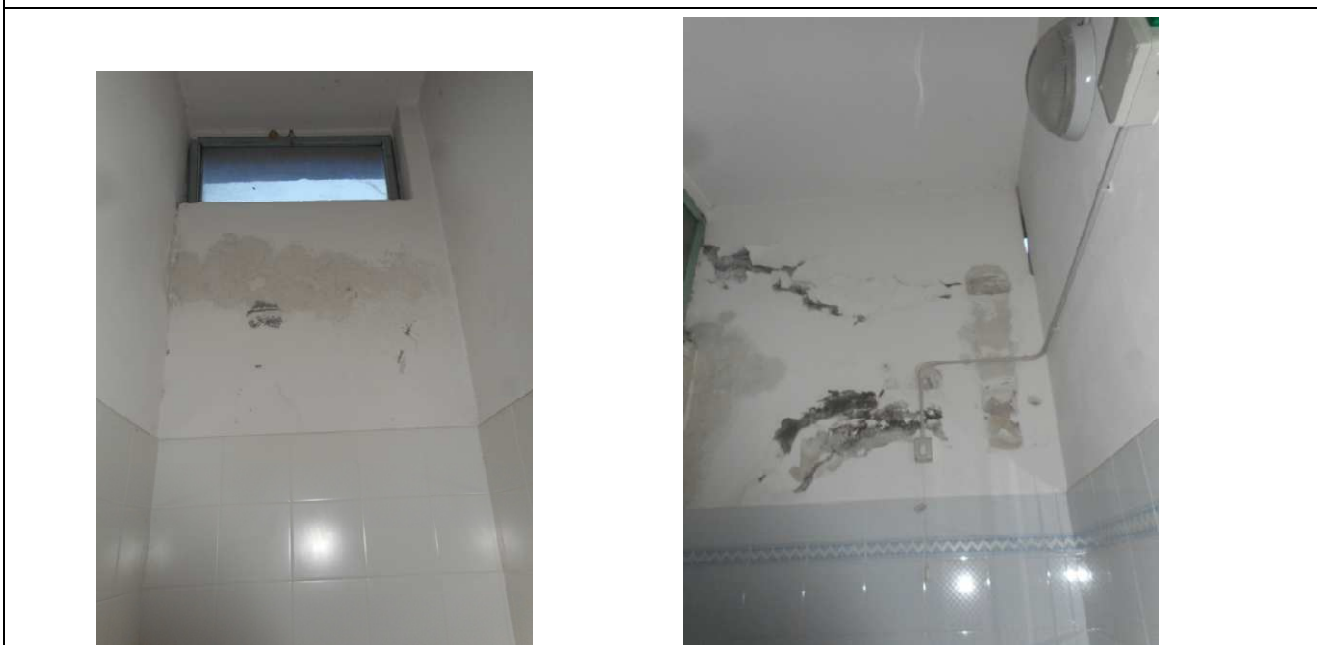
Infiltrazioni di acqua nei servizi igienici del primo piano (in alto a destra si vede l'esterno)
