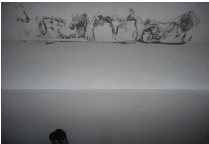
Infiltrazioni di acqua dal tetto nel refettorio (sopra aula Campani)
