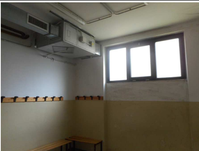
Veduta degli spogliatoi con le macchine per il trattamento dell'aria
