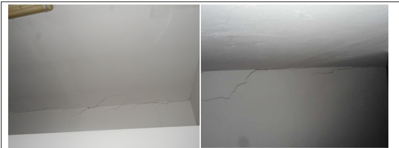
Lesioni in corrispondenza dei servizi igienici al primo piano (sopra l'aula Campani)
